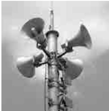
▶防災行政用無線施設整備で設置された放送施設
