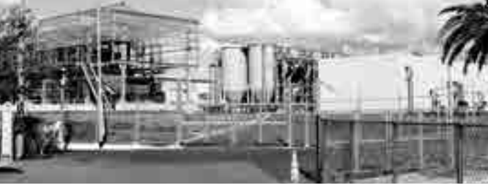
▲稼働中の中央浄水場
