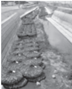
▲応急措置された西川
