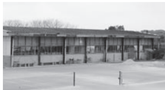
築35年余、老朽化が著しい鞍手北中の技術科教室
