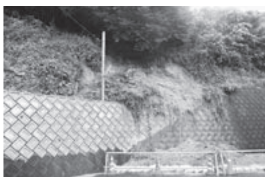
7月の集中豪雨によって、がけ崩れや道路損壊、水路破損などの災害が発生しました
