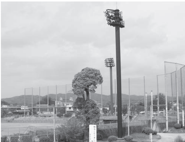
老朽化のため使用が出来なくなった町立野球場の照明設備
