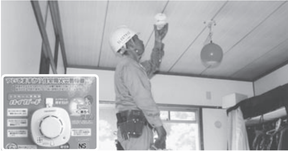
消防法が改正され、住宅に「火災警報器」の設置が義務付けられたので、町営住宅にも設置されます
