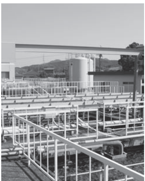
前ろ過装置が設置される浄水場 (中山北区)
