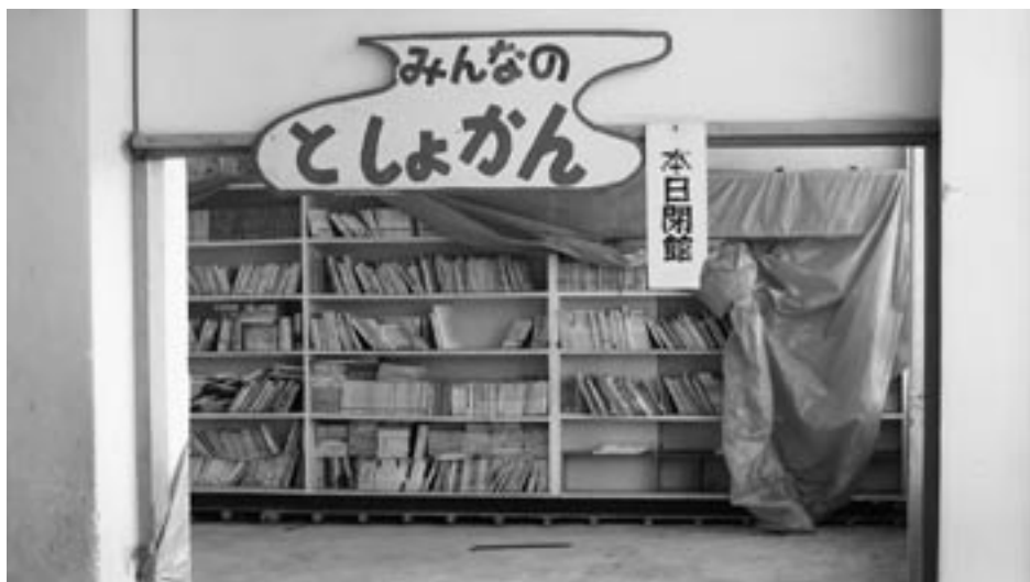
老朽化により、2年間も使用されていなかった特別教室棟（2階の図書室）
