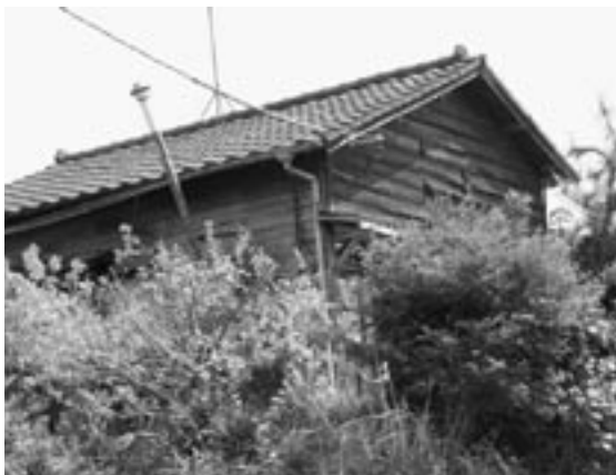
老朽化した新北町営住宅
