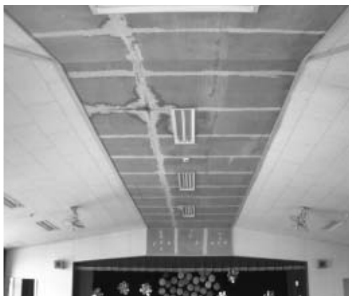
天井のクロスが剥がれたままの遊戯室（古月保育所）
