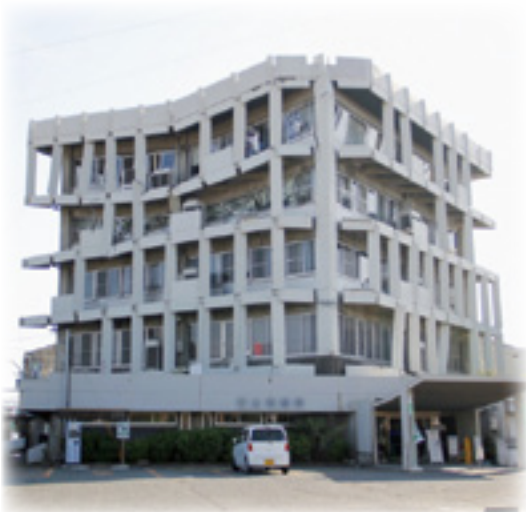
▶熊本地震で被災した自治体庁舎
