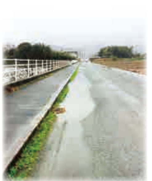
▶歩道脇に溜まった土砂
