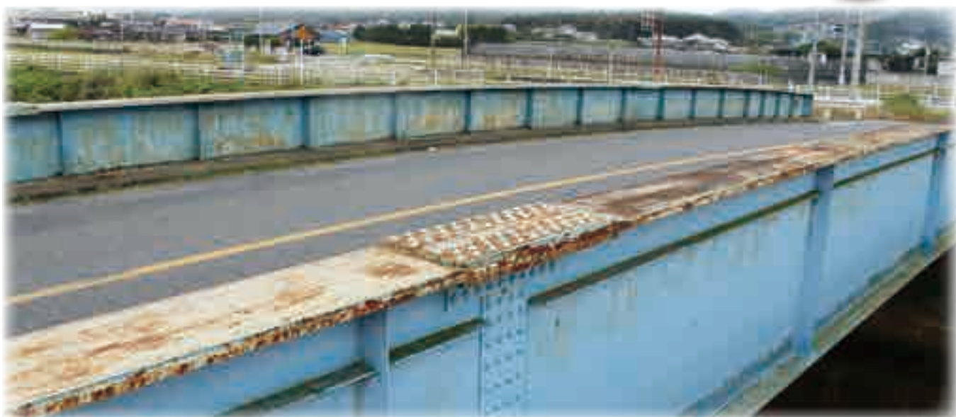
▶設置から50年経過により劣化が進む第二新延橋（役場より西川に向かった箇所）
