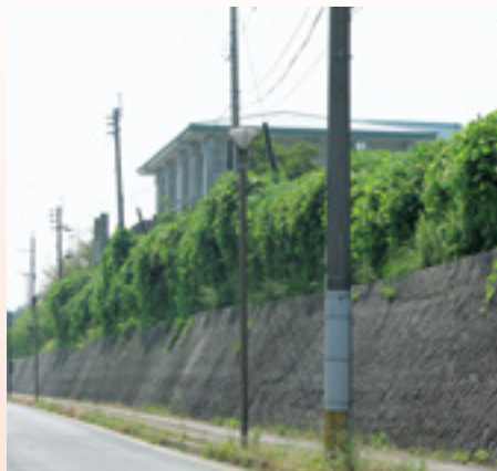
▶文化体育総合施設の北側擁壁に亀裂発生
