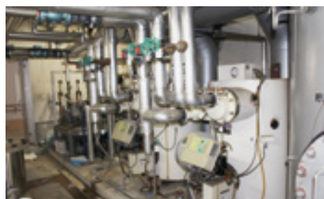
▶福祉棟給湯施設
