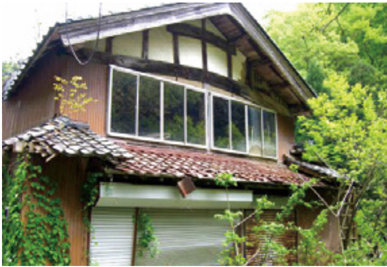
▶倒壊が危ぶまれる空き家（イメージ）
