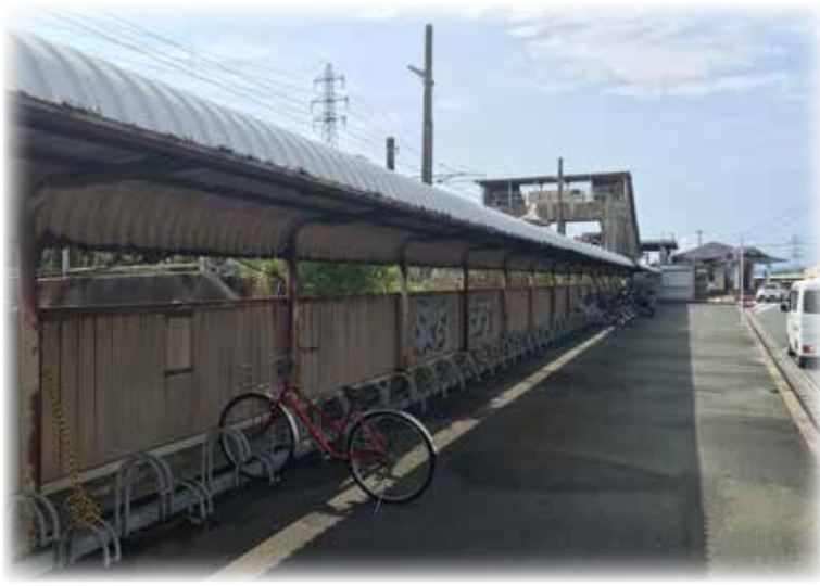
▶老朽化している鞍手駅駐輪場
