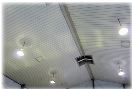
▶調理室にはエアコンが設置されていない
